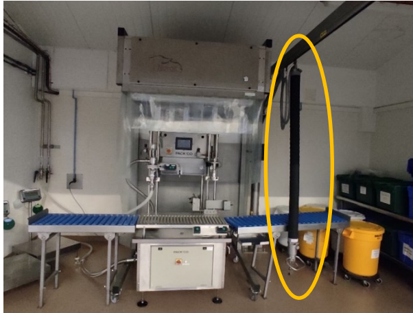
Bras de manutention – conditionneuse
