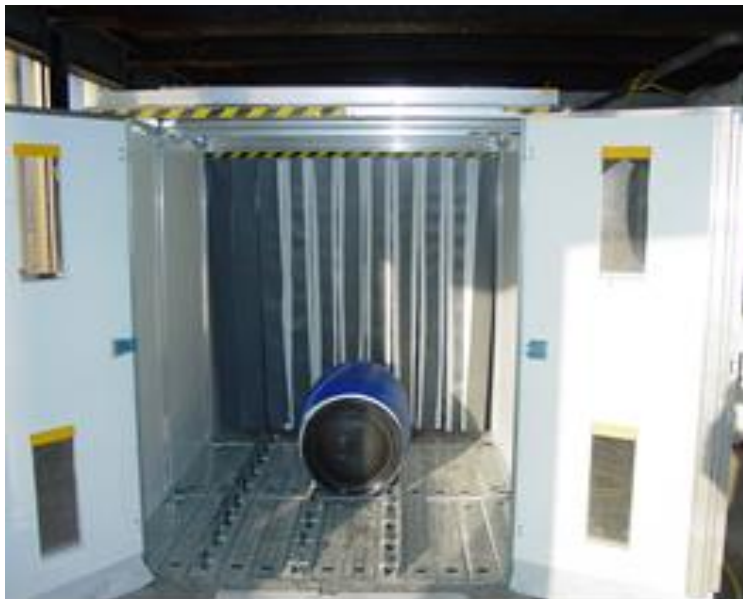
Sas matériel équipé de roulettes pour faciliter le passage des fûts de déchets
