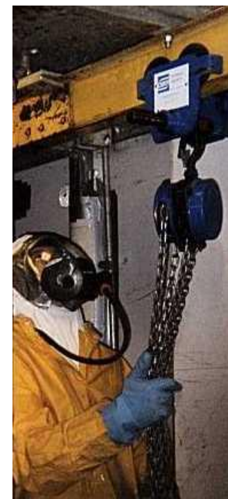
Sas matériel équipé d'un rail et d'un treuil
